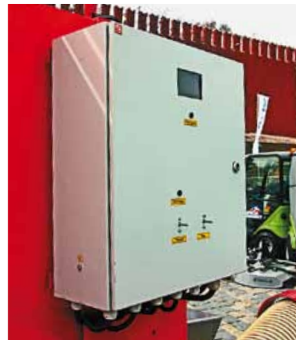
Электрический шкаф управления горелкой
